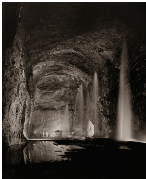
Figur 3. Bergrum för lagring av olja. Den ”svenska metoden” för lagring av olja i bergrum gick ut på att oljan lagrades på en vattenbädd, vattenet och oljan hölls i cirkulation av pumpar. På bilden provas pumparna. Fotografiet är taget den 24 oktober 1974. Foto: Järnvägsmuseet.
