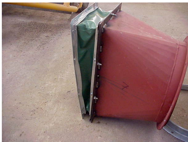
Figur 51. Bild av skador vid anslutning/utlopp efter skott 13.
