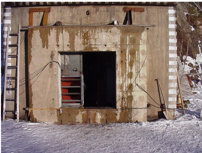
Figur 2. Bild av provkammare (från utsidan).
