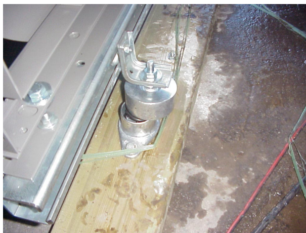
Figur 57. Bild av defekt vibrationsdämpare efter skott 14.
