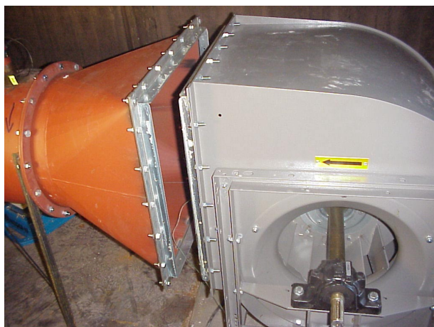
Figur 56. Bild av skador på anslutning/utlopp efter skott 14.
