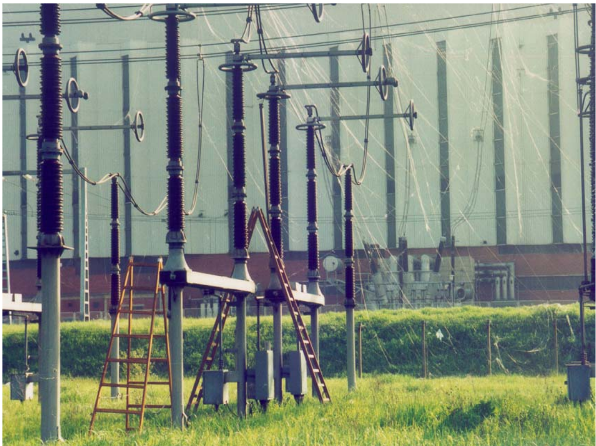
Bild 3.1. Transformatorstation i Drmno, 8 maj, 1999 efter att ha angripits med grafitbomber. 19
