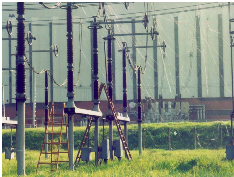
Transformatorstation i Drmno, 8 maj, 1999 efter att ha angripits med grafitbomber. Foto Electric Power Industry of Serbia
