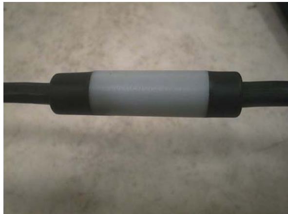
Figur 3. Temperatursensor och kort ingjutna på kabeln.
