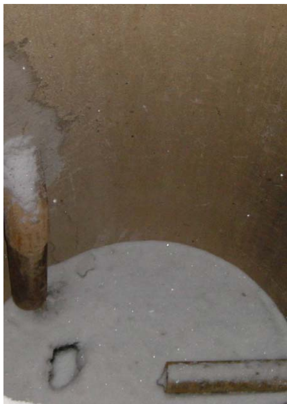
Figur 4. Oljeavskiljare som installerats vid deponins dräneringsutlopp.
