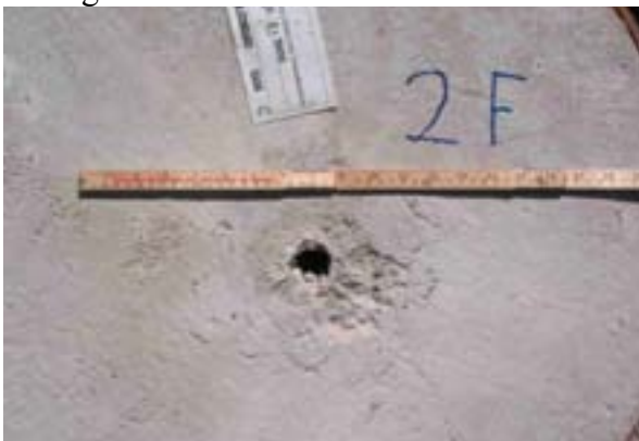
Figur B-9. Bild av framsida på det andra betongelementet efter skott 2.
