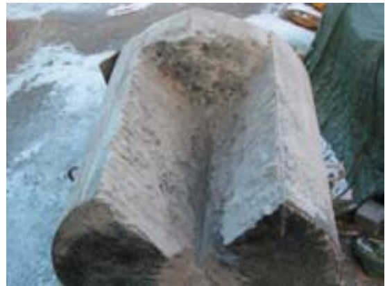
Figur A-15. Bild av blottlagd hålskanal i betongelement.
