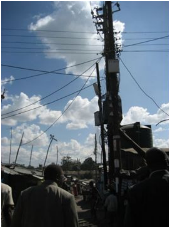
Bild. Provisoriskt (illegalt) elnät i slumområde (M’Kuru i Nairobi) (Foto B Liljedahl FOI)
