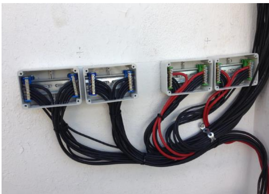
Figur 14. Inkoppling av solpanelerna på gymbyggnaden. 71
