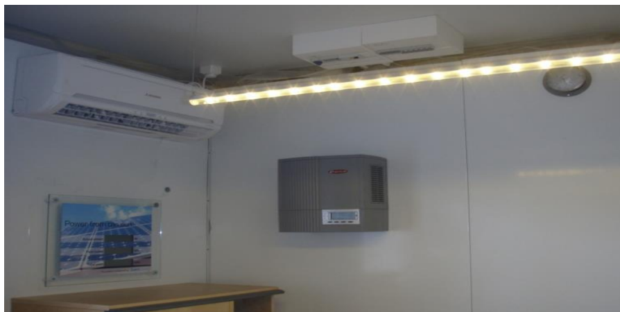
Figur 29. Del av interiör i kontorscontainer med övervakning av produktionen från solpanelerna.
