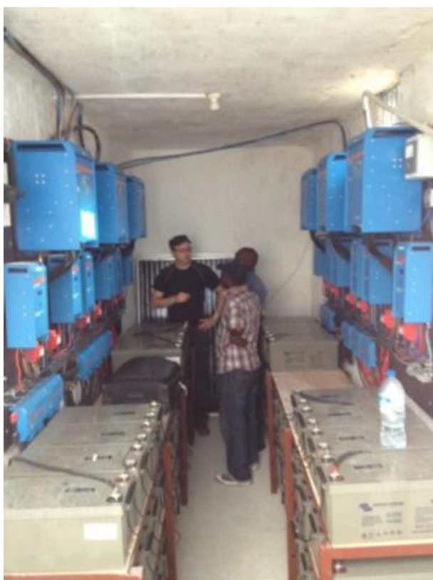
Figur 15. Den lokala personalen instrueras i hur systemet fungerar och hur det övervakas. På bilden ses även kontrollpanelen, batteribanken och säkerhetsbrytare (överst till vänster). 72
