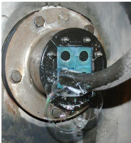
Serie 1 genomföring 14 läckage trycksida efter skott 6.
