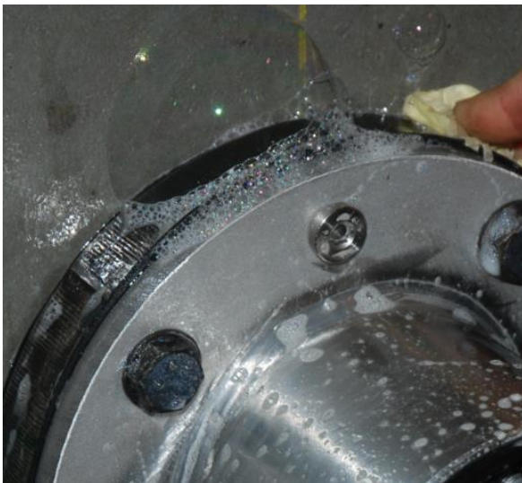
Figur 4.3 Läckage mellan packningsram och genomföring
