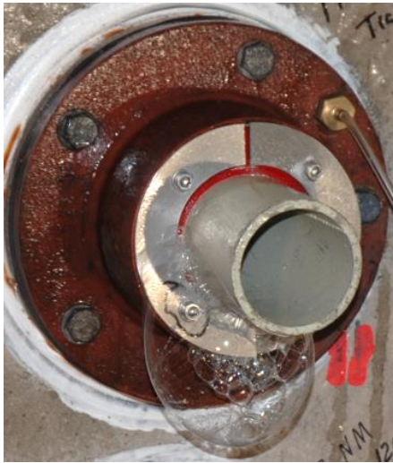
Serie 3 genomföring 11 läckage baksida före skott 3:1.
