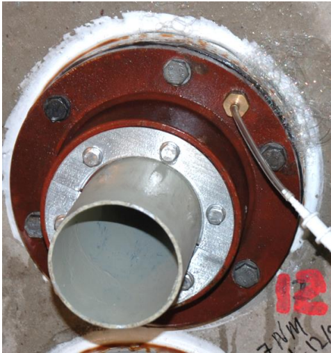
Serie 3 genomföring 12 läckage baksida före skott 1.
