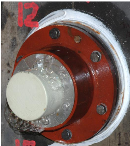
Serie 3 genomföring 12 läckage trycksida före skott 1.
