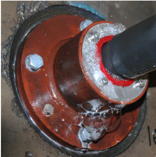
Serie 2 genomföring 16 läckage trycksida efter skott 3.
