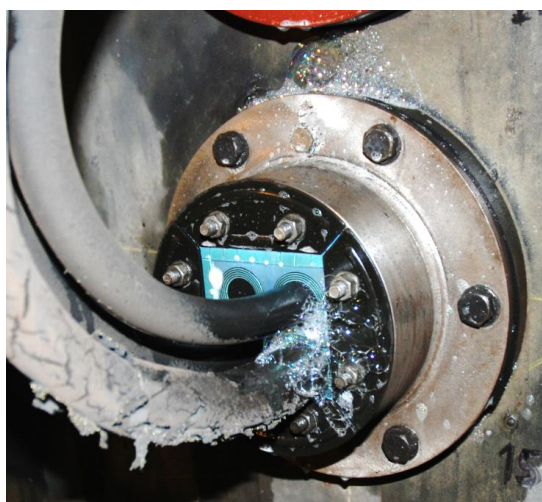
Serie 1 genomföring 15 läckage trycksida efter skott 6.
