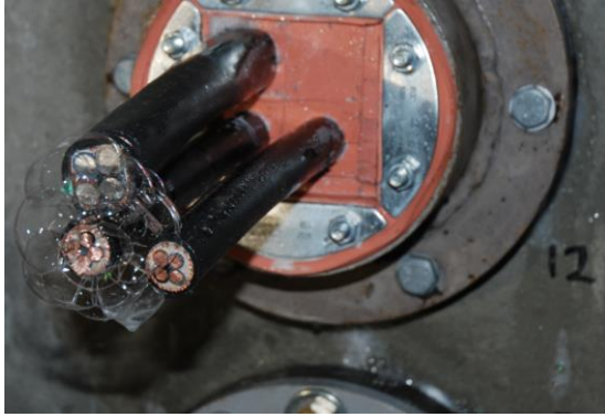
Serie 1 genomföring 12 baksida efter skott 2. Läckage i kablar via hölje.
