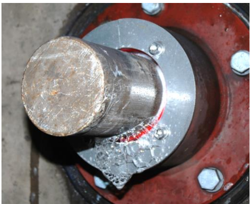
Serie 2 genomföring 17 läckage trycksida efter skott 1.
