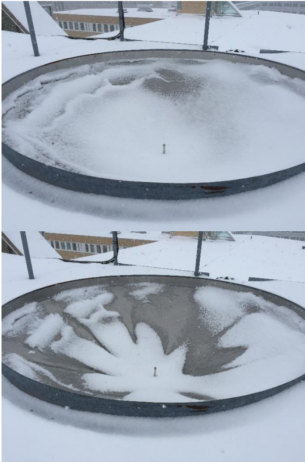
Figur 16. Testsköljning av tratten under vinterförhållanden, övre bilden innan sköljning och nedre bilden efter sköljning med 5 liter vatten.
