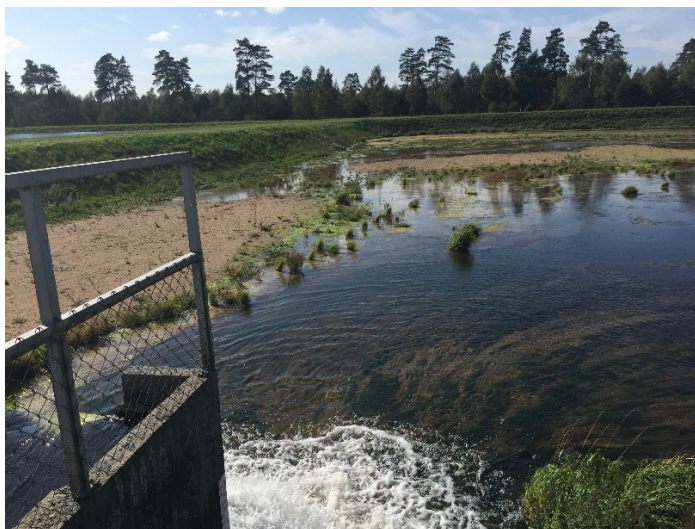
Figur 5. En infiltrationsdamm för dricksvatten i drift.
