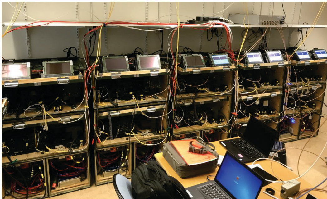
Figur 9. Fotografi som visar BMS-installationer uppställda i radionätslabbet. Bilden visar ena väggen där 10 radioenheter är uppställda. Längst ner står batterilådor och ovan på dessa två rader av radiolådor. Notera särskilt de två övre vänstra lådorna med KomNod. I utdragslådan på de övre lådorna har ställts fältdatorer som hör till respektive radioenhet.
