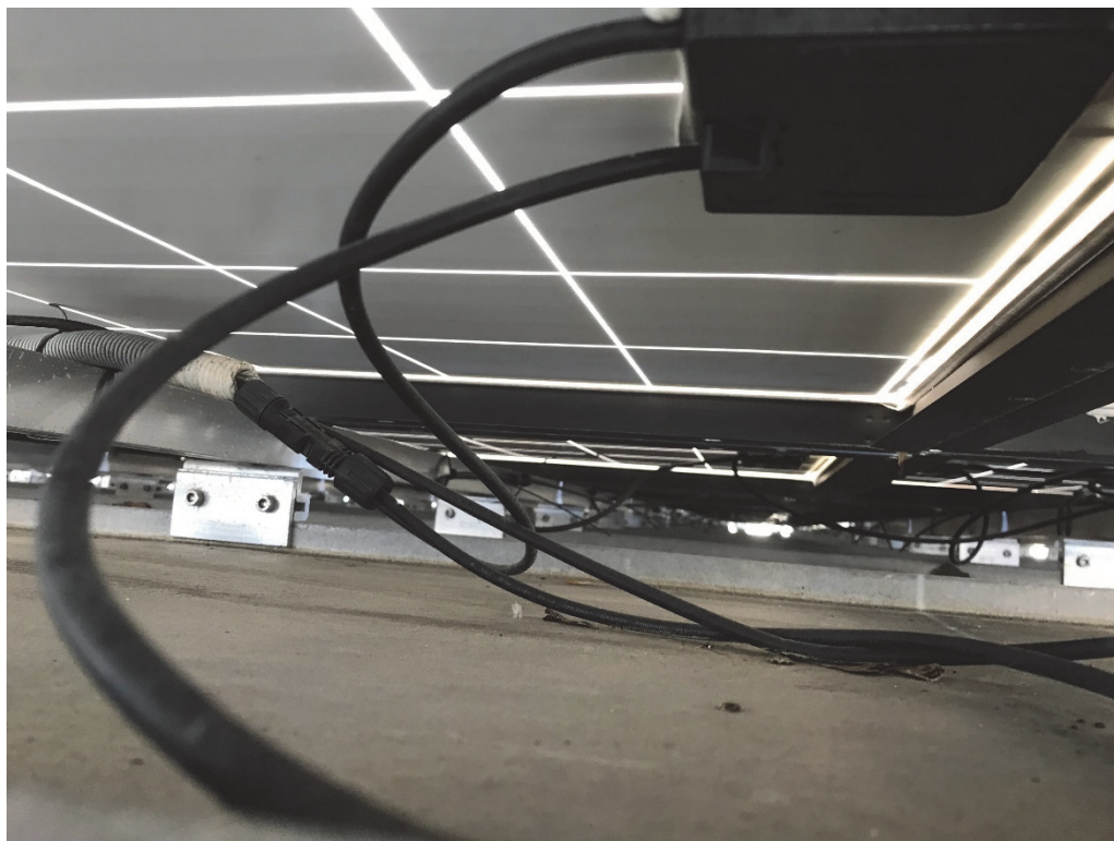
Figur 2. DC-kablage mellan plåttak och paneler på Tekniska verken.
